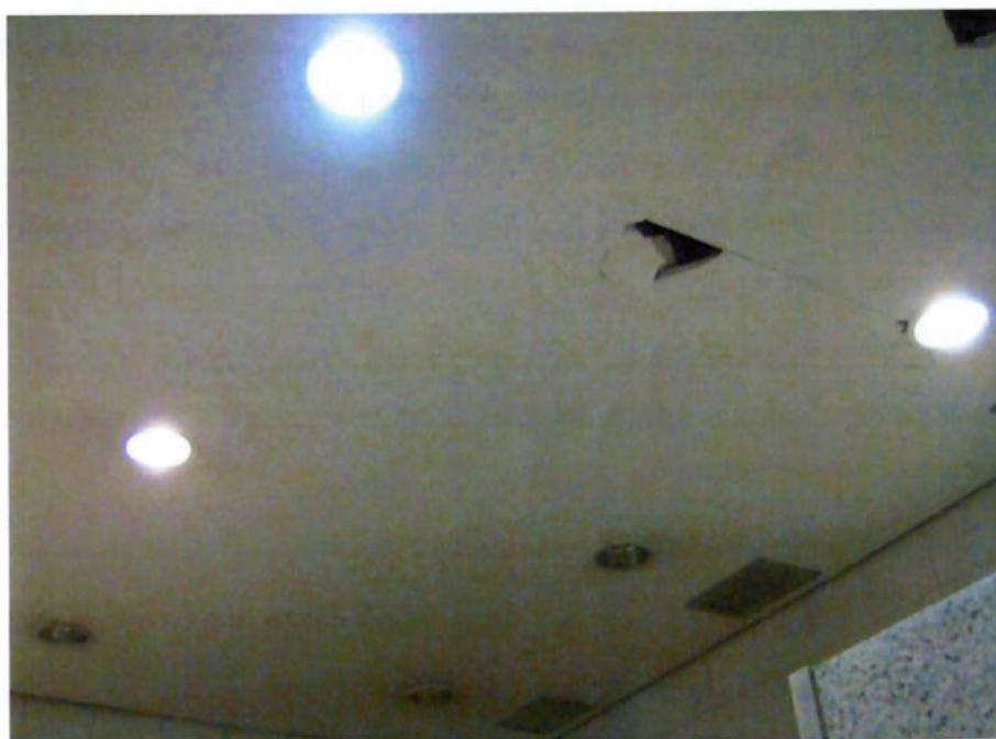
Imagem 10 - Lâmpadas compactas: com alta luminosidade (parte superior), baixa luminosidade e nenhuma (queimadas), sanitário da ala leste do andar superior
