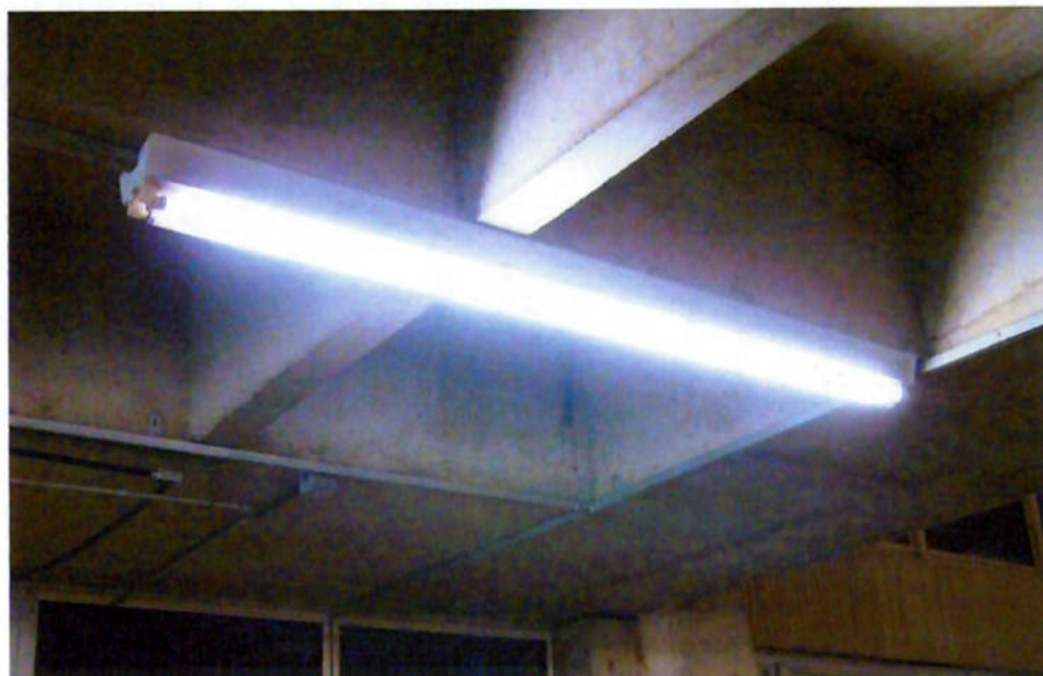
Imagem 8 - Lâmpada fluorescente 32W, hall de entrada do prédio
