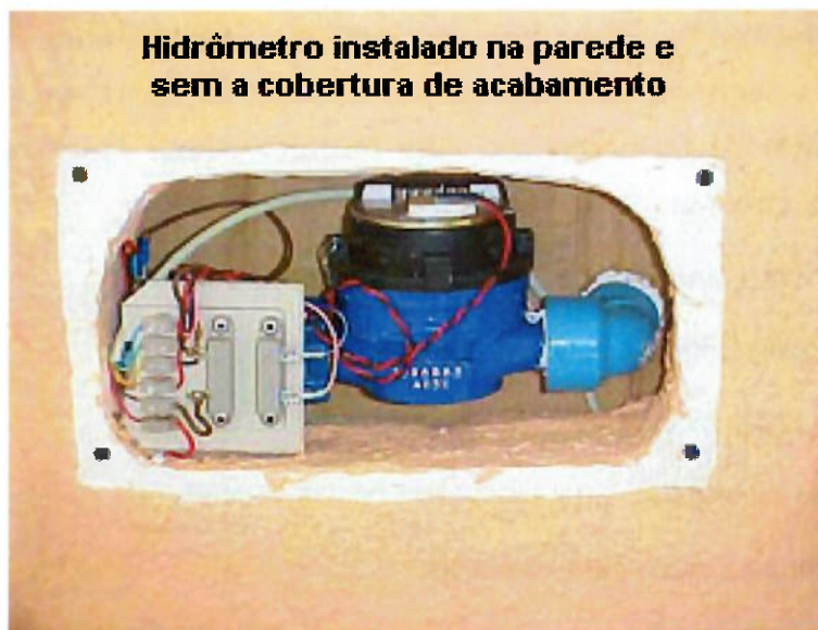
Imagem 12 - Hidrômetro individual para edifícios antigos
